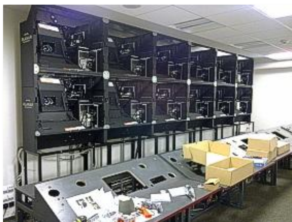
Instalace videostěny na operačním středisku MP Ostrava
