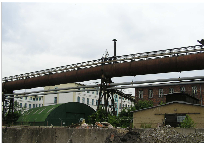
Obr.5 Pohled na část vyhořelého potrubí
